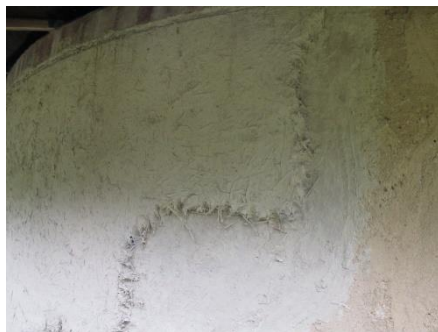
Figure 16 Cicatrice dans le mur de la paillourte à Nanterrel.
